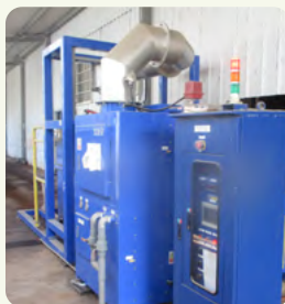
污泥處理相關設備
